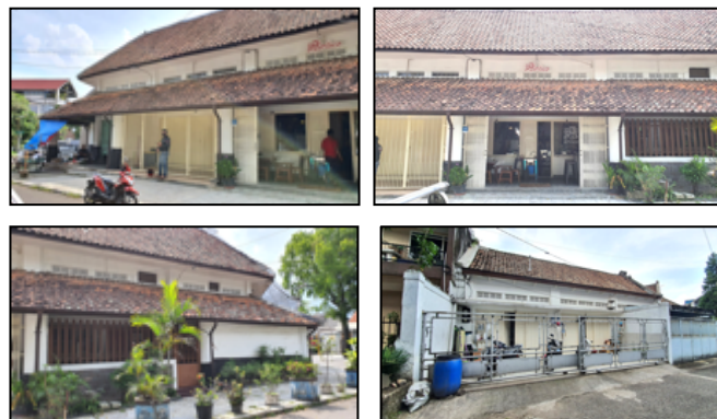
Gambar 2. Tampak depan bangunan (atas) dan tampak belakang bangunan (bawah) Sumber: Dokumentasi Tim Peneliti (2020)
