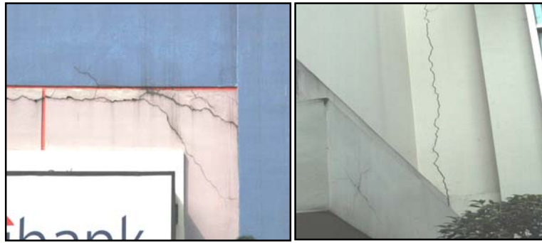
Gambar 7 Retakan pada Dinding.
