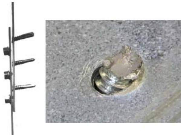
a. Tepi lubang pelat yang mengalami elongation akibat geser sekrup
